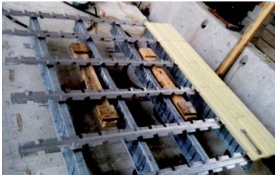
Рис. 3. Каркас кріплення зразка фасадної системи на залізобетонній стіні з фрагментом фасадного каменю
