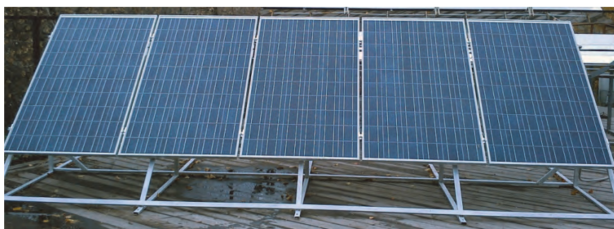
Рис. 6. Солнечная энергетическая установка мощностью 1150 Вт
