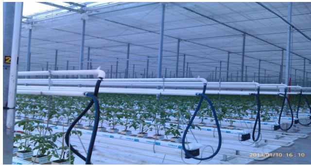
Рис. 3. Обігрівні труби опалювальної системи в теплиці
