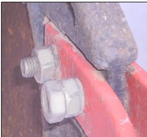
Рис. 3. Розмір конгргайки не відповідає розміру основної гайки.
