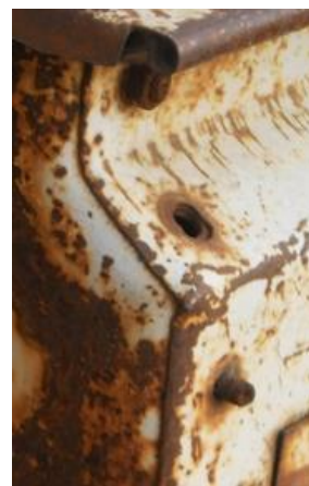
Рис. 2. Відсутність болтового з'єднання, гайки на зерновому ящику.
