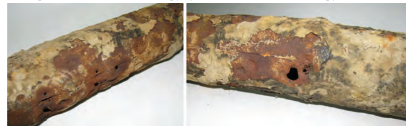
Рис. 1. Фрагменти підземного газопроводу низького тиску (Ø 60 мм) з наявними електрокорозійними дефектами типу "свищ"
