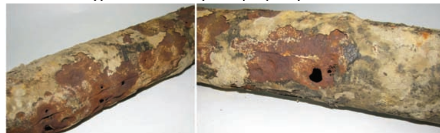
Рис. 1. Фрагменти підземного газопроводу низького тиску (Ø 60 мм) з наявними електрокорозійними дефектами типу "свиц"
