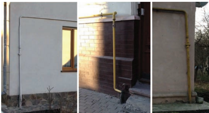
Рис. 4. Відсутність ізолювальних фланців на газових вводах у будівлі
