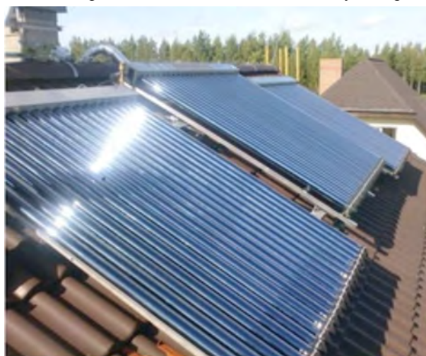
Рис. 5. Сонячні колектори на даху житлового будинку
