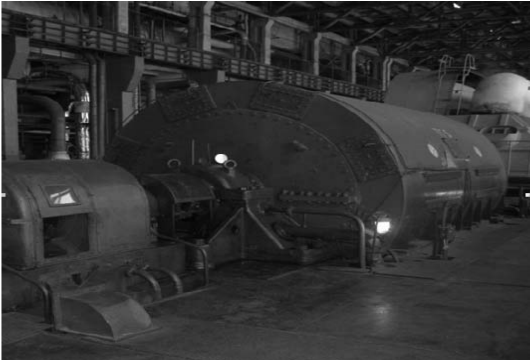
Рис. 1. Турбогенератор ТГВ-100 у машинному залі теплової електростанції
