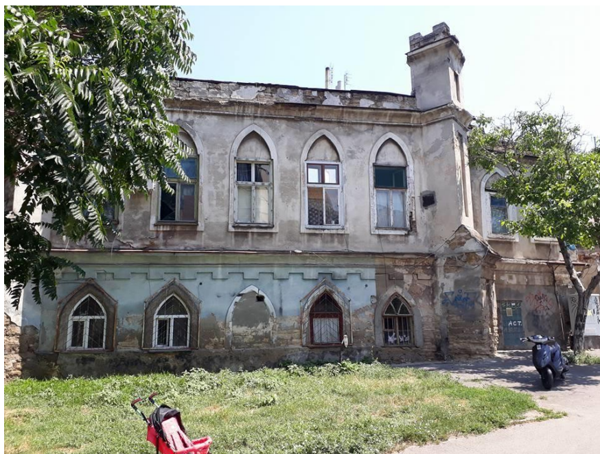
Рис. 1. Дом Брижинского. 1835 г., архитектор Ф. Боффо (Одесса, ул. Пастера, 1) (Снимок 2017 г.). Фото С. Эльмира.
