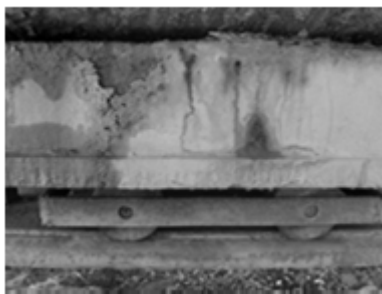
Рис.2 Корозія елементів рухомої опори та труби.
