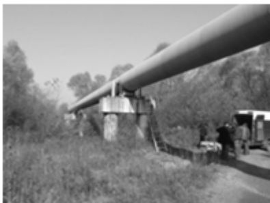
Рис.1 Надземний перехід магістрального газопроводу через р. Стрий.
