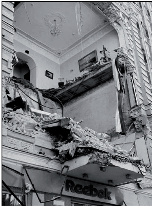
Рисунок 1. Обрушення фасадної стіни в процесі реконструкції будинку
