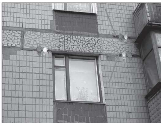
Рисунок 1. Деформация здания и, как результат, разрушение цементно-песчаного раствора замоноличивания стыков наружных стеновых блоков
