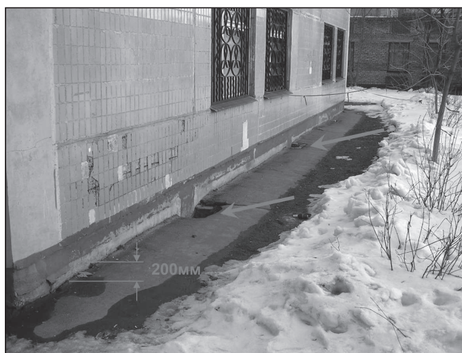
Рисунок 5. Проседание и разрушение отмостки вокруг здания, уклон отмостки в сторону здания. Вентиляционные приемки не защищены от проникновения в подвал атмосферных осадков
