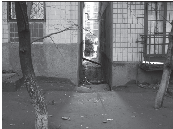
Рисунок 2. Отмостка между блоками здания в деформационном шве выполнена с уклоном к зданию и способствует аккумуляции дождевых и талых вод, их проникновению в грунт и, как следствие, деформациям здания
