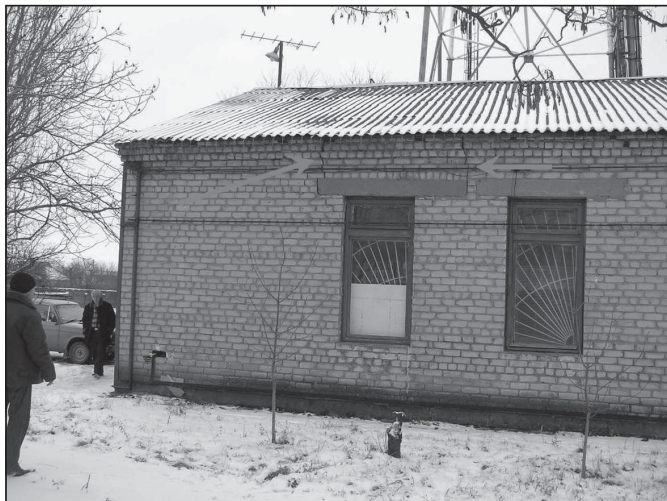
Рисунок 3. Трещины раскрытием до 30 мм в наружных стенах, отсутствие отмостки вокруг здания, планировка территории, не обеспечивающая быстрый и беспрепятственный отвод дождевых и талых вод от здания
