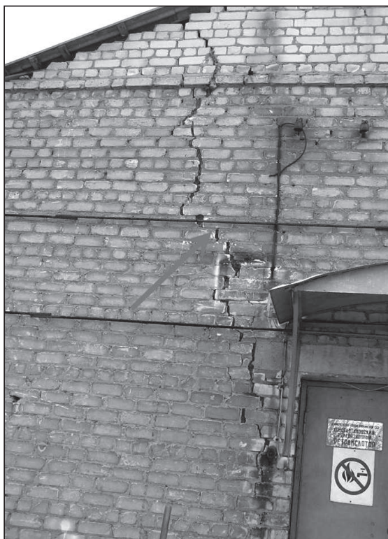
Рисунок 4. Трещины раскрытием до 30 мм в наружных стенах здания – результат замачивания и неравномерного оседания грунтов основания
