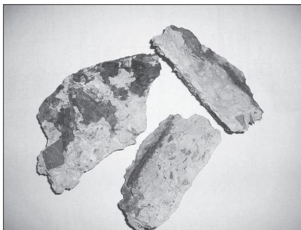
Рисунок 6. Зразки бетону зруйнованої балконної плити
