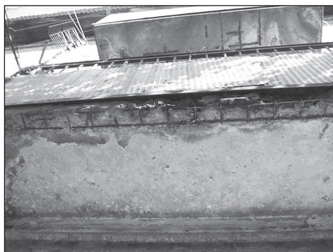
Рисунок 4. Оголення та корозія арматури
