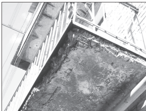
Рисунок 3. Відколи, руйнування бетону балконних плит
