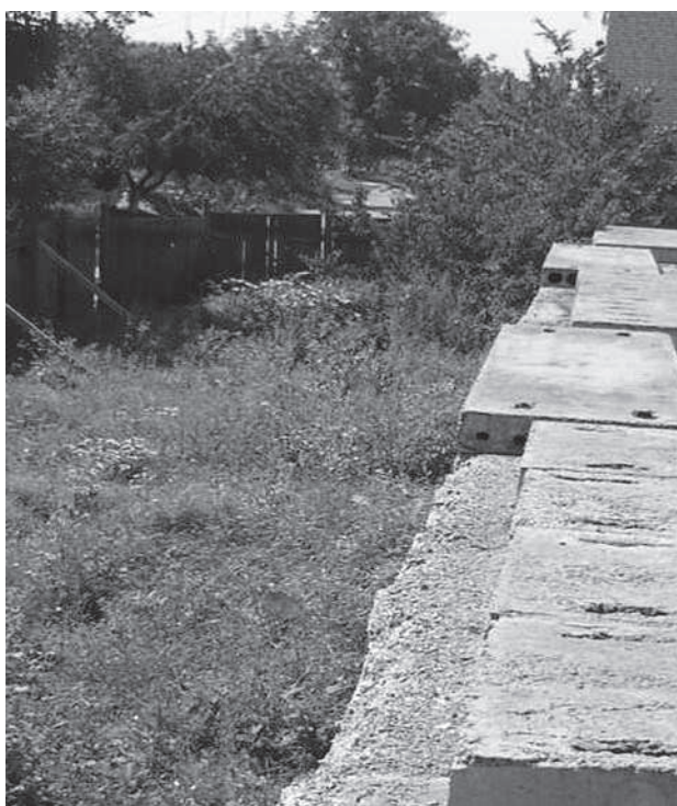
Рисунок 5. Вивітрювання бетону монолітних ділянок
