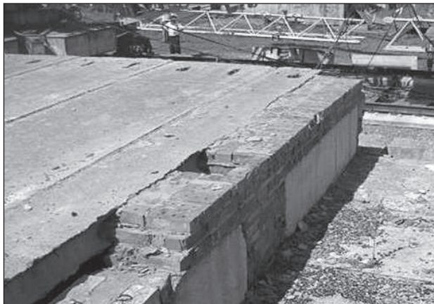
Рисунок 4. Вивітрювання цегляної кладки сходової клітини
