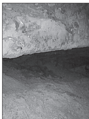
Рисунок 5. Відсутність ґрунтів основи під підшоною фундаменту за рахунок їх вимивання техногенними водами
