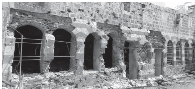
Рис. 6. Разрушенные здания старого квартала в городе Хомс (объект всемирного наследия ЮНЕСКО)
