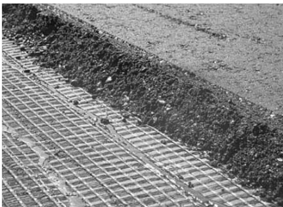
Рис.3 Влаштування бетонної основи з малоцементних жорстких бетонних сумішей, що вкладаються трамбуванням або механічними котками.
