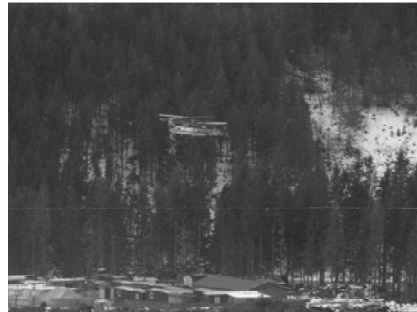
Рис.2 Подавання бетонних сумішей при будівництві підйомників в гірській місцевості взимку п. Буковель.
