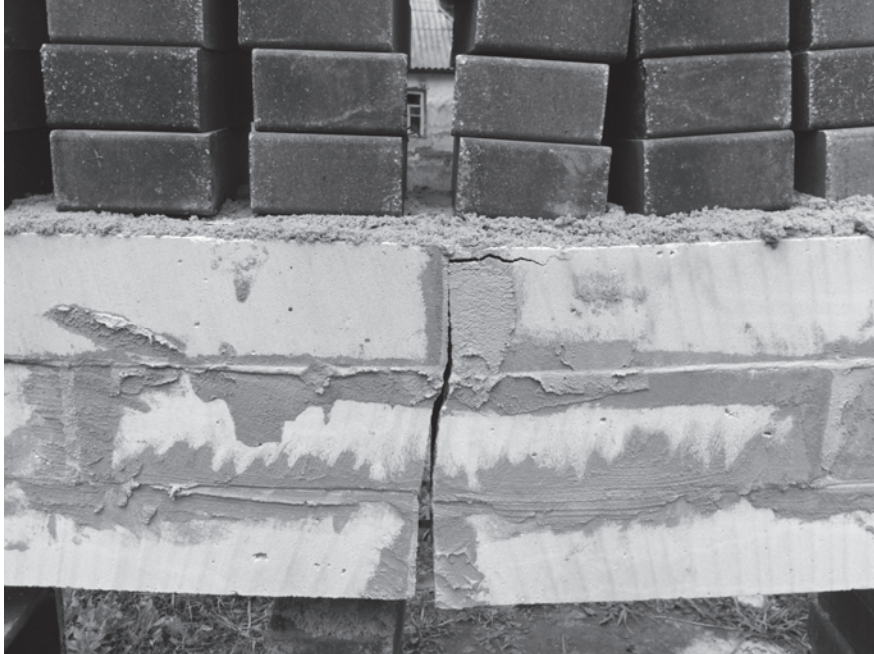
Рис. 6. Образование продольной трещины в сжатой зоне перемычки
