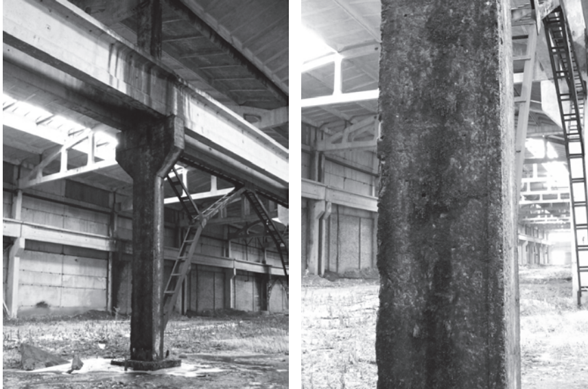
Фото 1. Пошкодження залізобетонної колони та підкранових балок біокорозією
