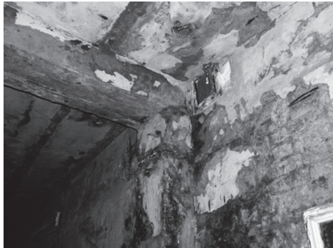
Фото 2. Пошкодження залізобетонного покриття біокорозією
