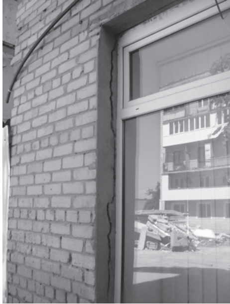
Рис. 8. Тріщина в торці простінку
