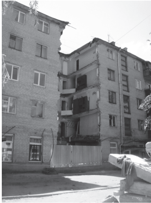
Рис. 1. Руйнування житлової будівлі
