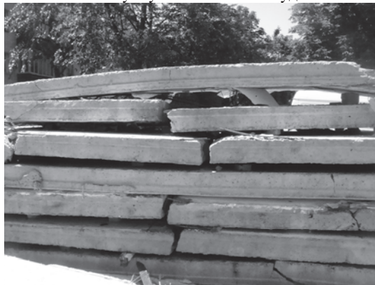
Рис. 2. Зруйновані конструкції будівлі на прибудинковій території П'ятиповерховий житловий будинок на чотири під'їзди має розміри в плані 72,14 x 12,74м, кількість квартир – 56. Збудований на початку 70-х років
