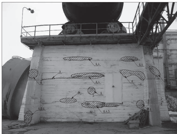
Рис. 4. Дефекти і пошкодження опори П6/О2: 3-тріщини, 4-оголена (корозія) арматури, 5-відшарування (руйнування) бетону, 6-пори, раковини
