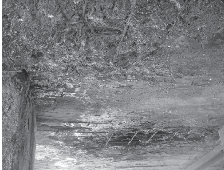
Фото. 5. Руйнування бетону плити та колони опори П6/О4
