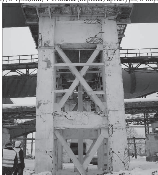
Рис. 12. Дефекти і пошкодження опори П6/О6: 1- золи бетону, 3-тріщини, 4-оголена (корозія) арматури
