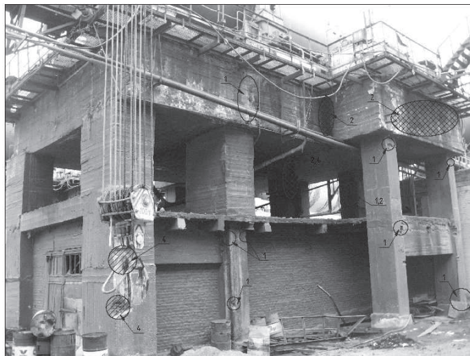
Рис. 6. Дефекти і пошкодження опори П5/04: 1- зколи бетону, 2-корозія та руйнування бетону, 3-тріщини, 4-оголена (корозія) арматури
