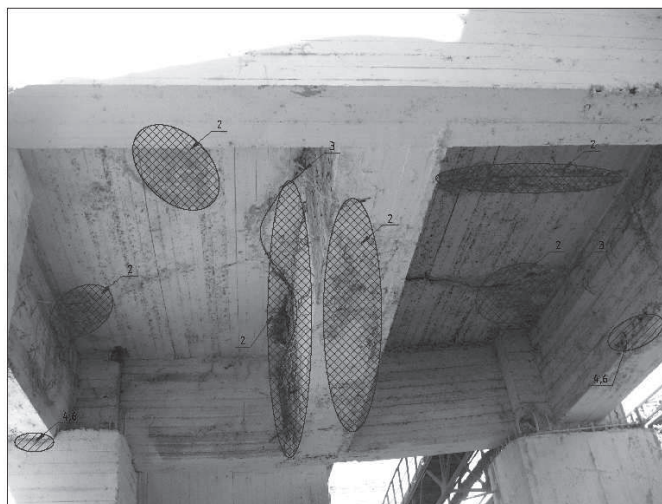
Рис. 11. Дефекти і пошкодження плити П5/О3: 1- золи бетону, 2-корозія та руйнування бетону, 3-тріщини, 4-оголена (корозія) арматури, 6-пори, раковини бетону
