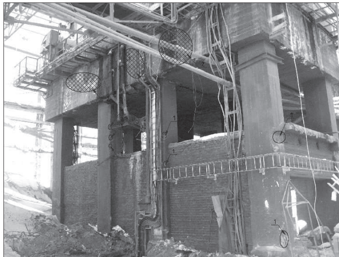
Рис. 9. Дефекти і пошкодження опори П4/О4: 1- зколи бетону, 2-корозія та руйнування бетону, 3-тріщини, 4-оголена (корозія) арматури
