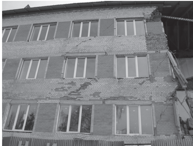
Фото 2. Тріщини в зовнішній стіні будівлі
