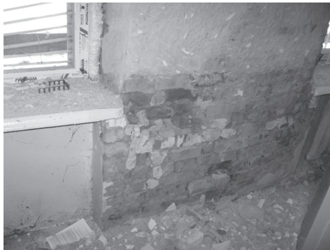
Фото 6. Зволоження та руйнування кладки стіни першого поверху
