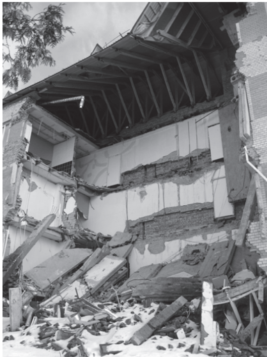
Фото 1. Руйнування будівлі поліклініки ЦРЛ у м. Ізяслав
