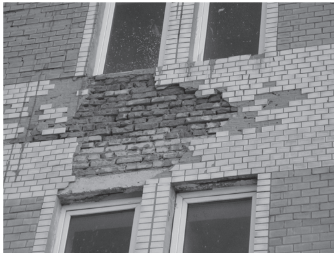
Фото 4. Ділянка стіни з частково зруйнованою кладкою
