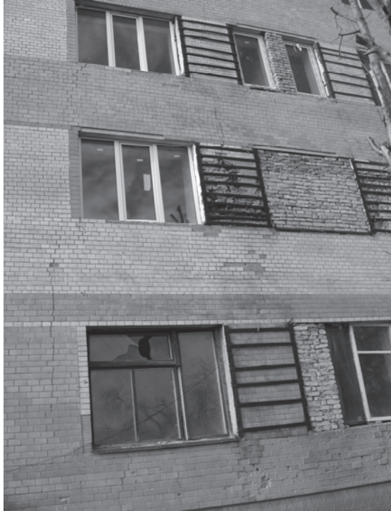
Фото 3. Тріщини в зовнішній стіні та металева обійма протітків
