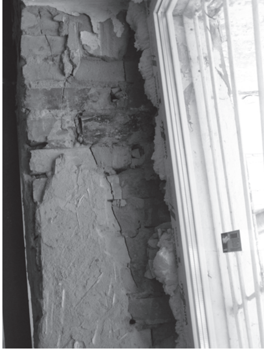
Фото 5. Тріщини в кладці простінка
