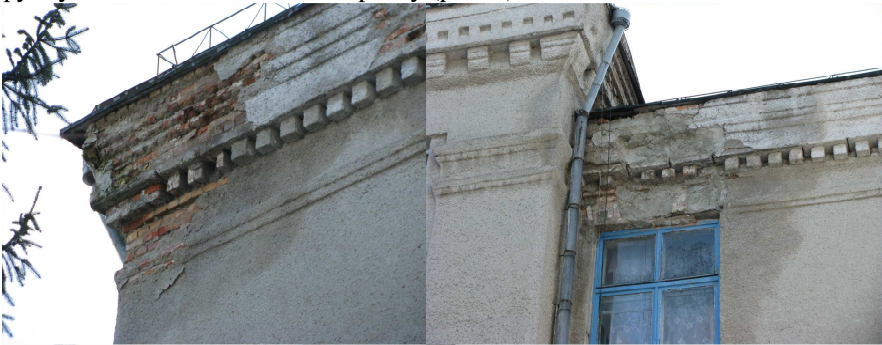
Рис. 3. Замокання карнизу ЗОШ №7 м. Дубно
