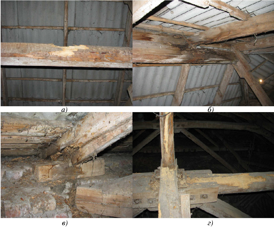
Рис. 2. Дефекти та пошкодження дерев'яних конструкцій покрівлі ЗОШ №7 м. Дубно
