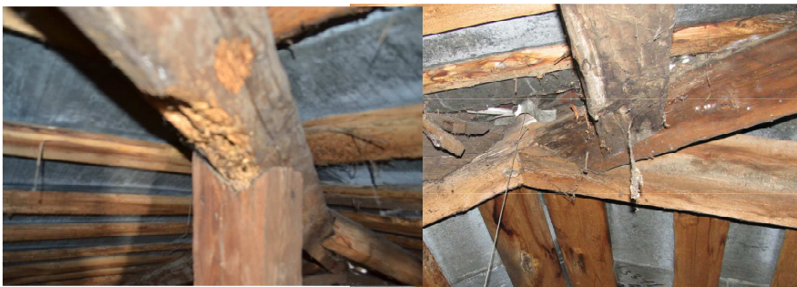
Рис. 5. Ураження гниллю деревини деталей даху адміністративної будівлі в м. Дубно
