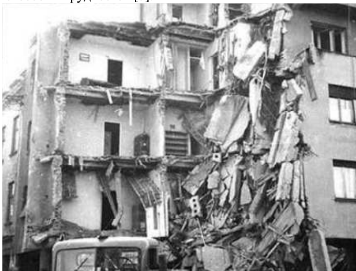
Рис. 2. Землетрясение 27 октября 1969 г. в Бане Луки (Югославия)
