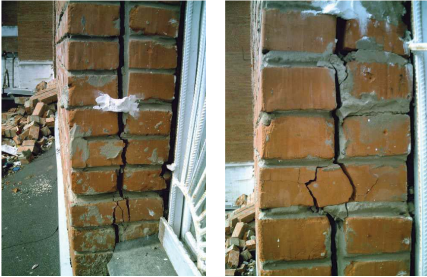
Рис. 2. Чисельні тріщини в простінках в місцях потовщення
