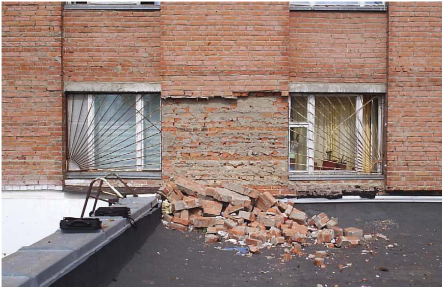
Рис. 1. Часткове обвалення зовнішнього шару кладки одного з простінків зовнішньої несучої стіни
