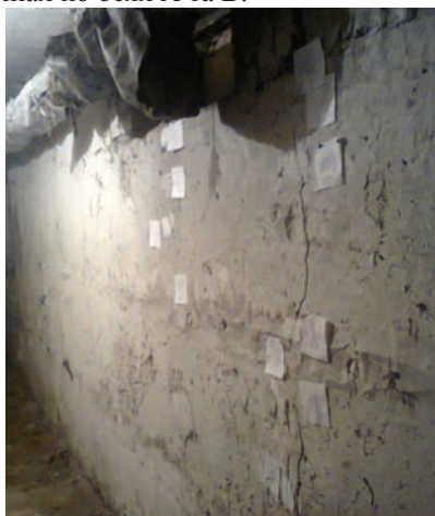
Рис. 4. Тріщина в зовнішній стіні підвалу
