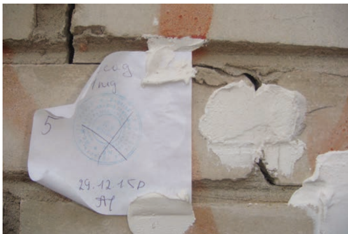
Фото. 2. Тріщини в кладці зовнішньої стіни будівлі, встановлення маяків
