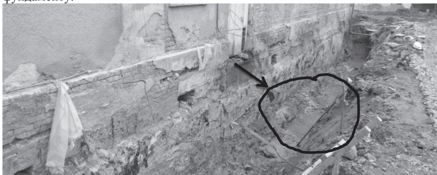
Рис. 2. Стан існуючих стрічкових фундаментів будівлі, що реконструюється на вул. Драгоманова в м. Рівне (підтоплення ґрунтовими водами, викликане атмосферними опадами)
