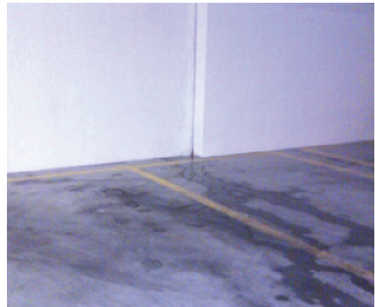
Fotografia. 6. Przeciek z dylatacji konstrukcyjnej.
