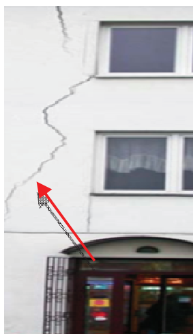
Fotografia 2. Uszkodzenia budynku sąsiadującego z nowo realizowanym jednokondygnacyjnym garażem podziemnym [8].
