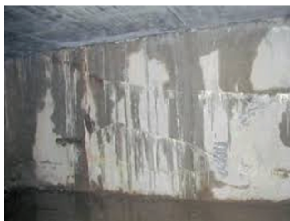
Fotografia 4. Zainiektowane rysy w ścianie oraz częsty widok pozornych Przecieków wody opadowej pochodzącej z wyższych kondygnacji [8].
