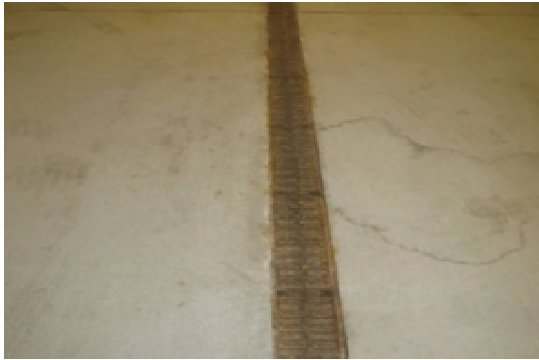
Fotografia. 7. Widoczne ślady korozji wskutek zalegania wody w korycie
