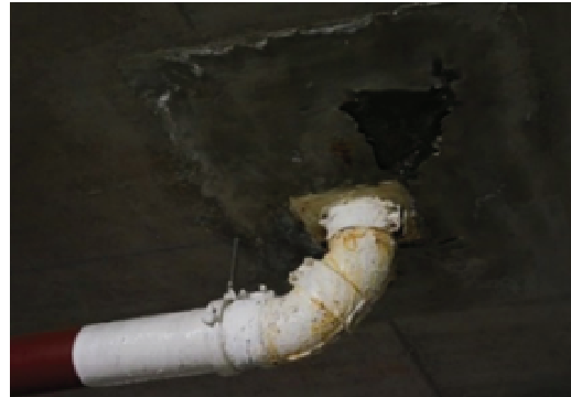
Fotografia.8. Wykwity przy przejściu rury przez strop pośredni w garażu wielopoziomowym
