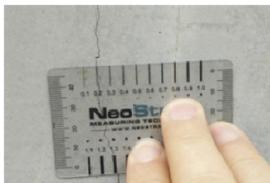
Fot. 10. Pomiar szerokości rysy
