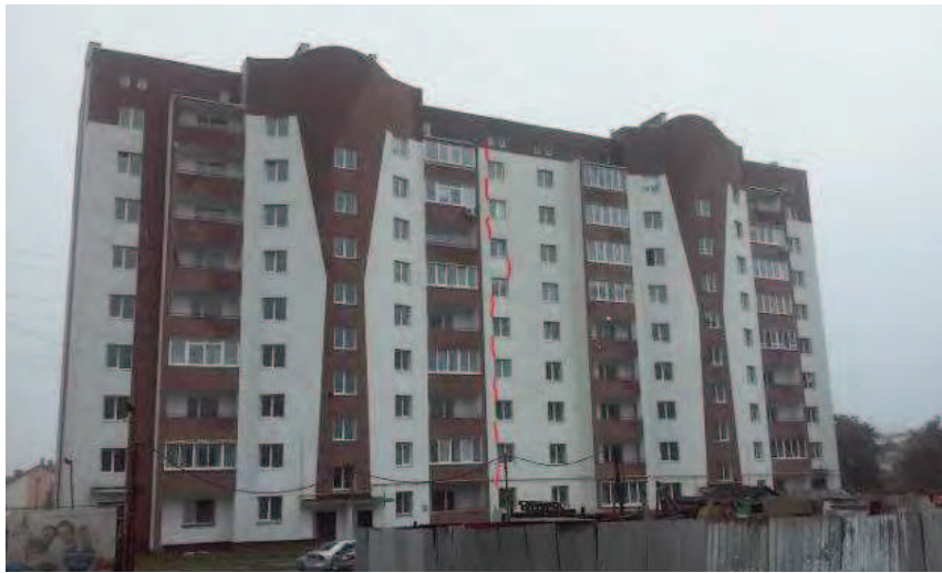
Фото. 1. Фасад будівлі з тріщинами на висоту поверхів
