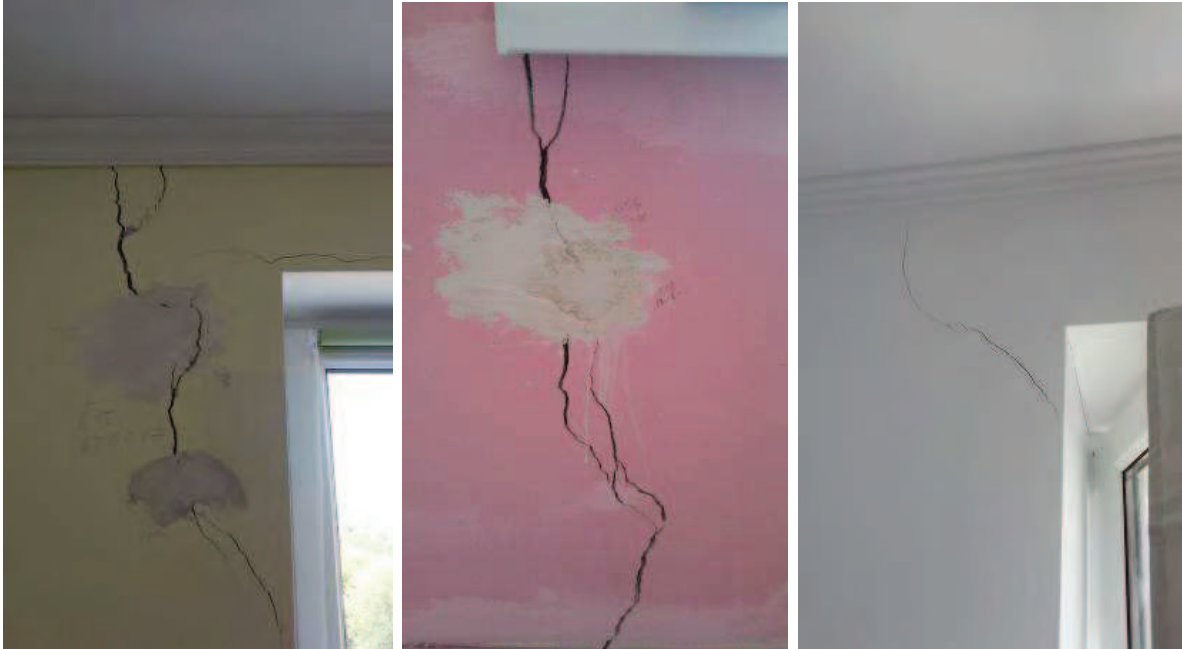
Фото. 3. Тріщини у зовнішніх несучих стінах будівлі
