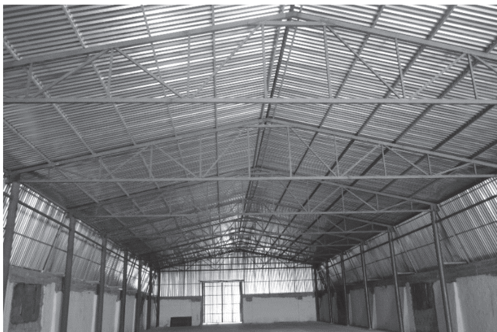
Фото 1. Вигляд каркасу складу. Кроквяні ферми мають наднормативні прогини
