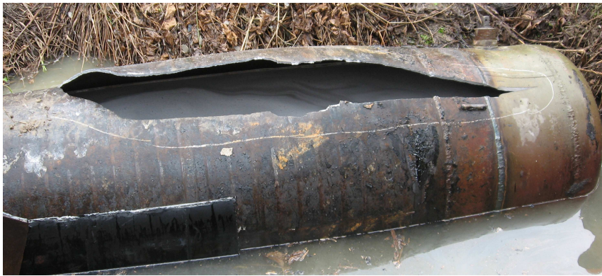
Рисунок 7 – Ділянка руйнування труби
