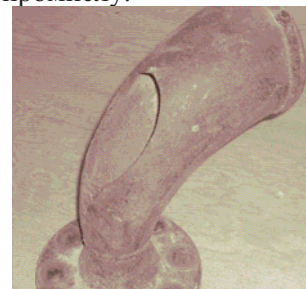
Рисунок 5 – Результати ерозії-корозії на згинах трубопроводу природного газу
