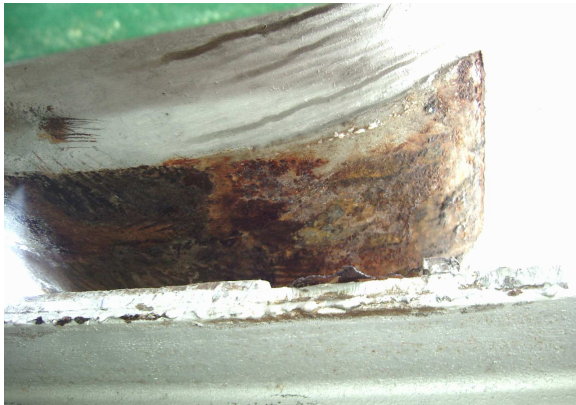
Рисунок 2 – Пляма корозії в місці контакту трубопроводу із сідловиною опори
