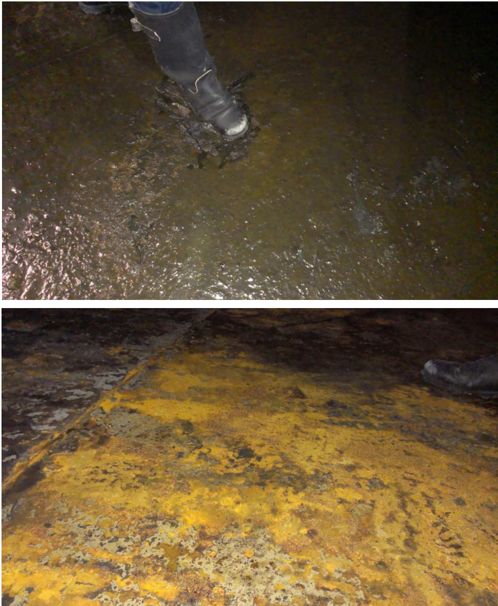
Рисунок 8 – Корозійне пошкодження днища резервуара РВС 1000 №1
