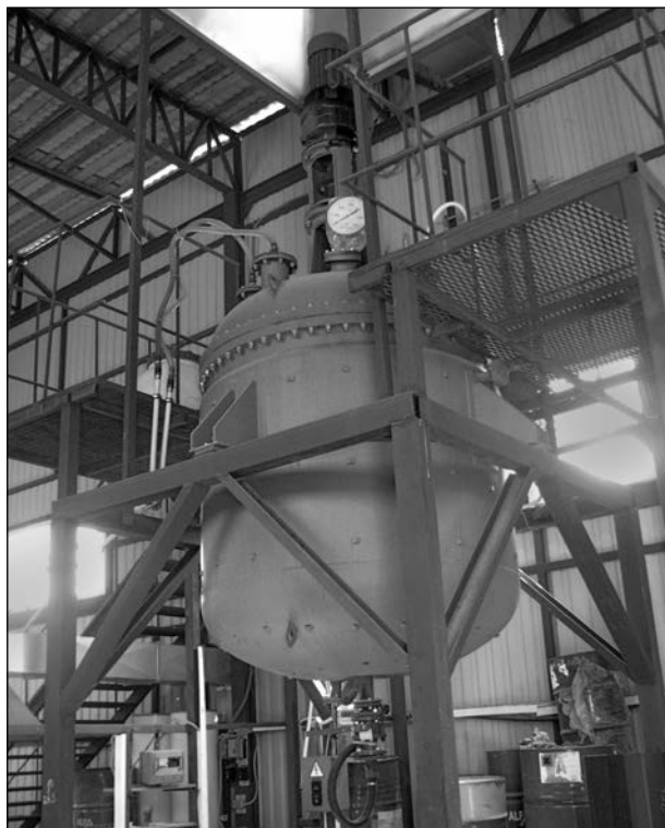
Рис. 5. Реакторне відділення дослідно-промислового цеху з виробництва поліолієвих компонентів «А» поліуретанових ін'єкційних матеріалів
