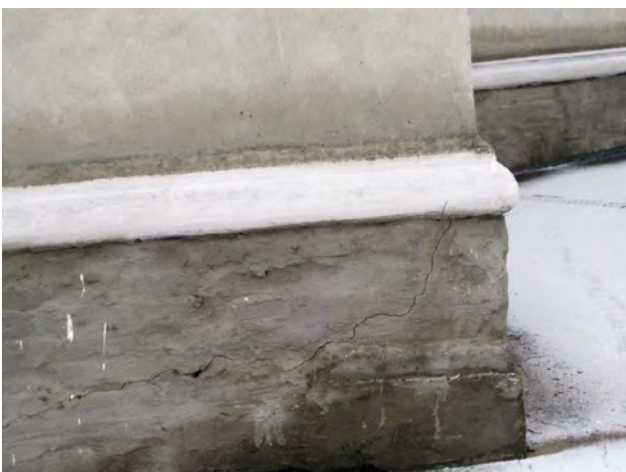
Рис. 5. Фотофіксація тріщини (деформації) фундаменту будівлі храму
