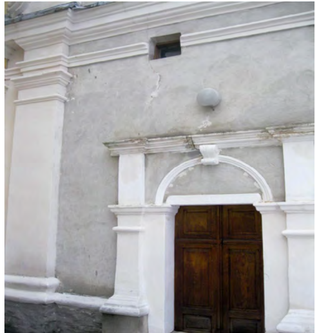
Рис. 6. Фотофіксація зовнішньої тріщини (деформації) над входом до храму
