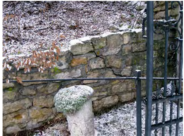
Рис. 8. Фотофіксація тріщини підпірної стінки схилу тераси
