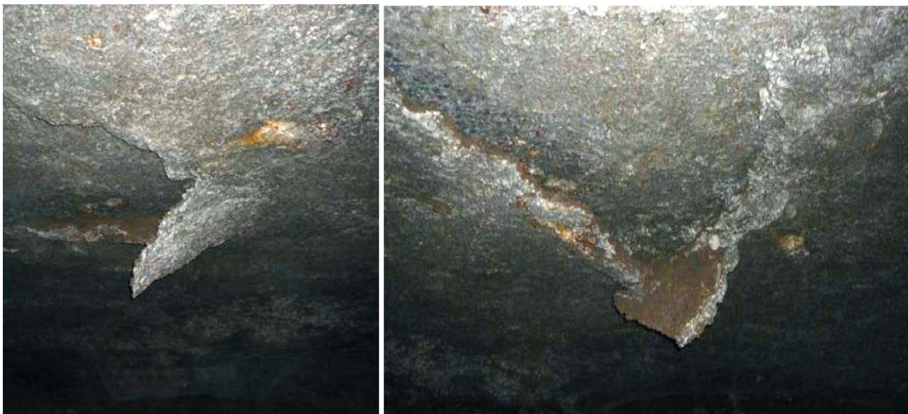
Рис. 26. Отслоение сульфатной породы в кровле пещеры, обусловленное взаимодействием ангидрита с конденсационной влагой (гидратация ангидрита). Грот Грязный.
