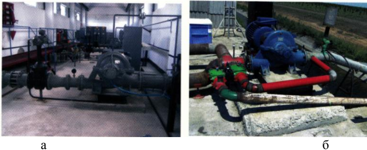
Рис. 2 – Види насосних станцій: а – електрична стаціонарного розміщення; б – електрична станція тимчасового розміщення
