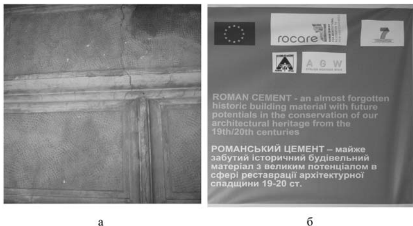
Рис. 1. Характеристична усадочна тріщина на боковому фасаді будівлі (н.к. 21) НУ «Львівська політехніка» (а) та інформаційний стенд Європейського проекту EU-project ROCARE в сфері реставрації архітектурної спадщини XIX–XX ст. (б)
