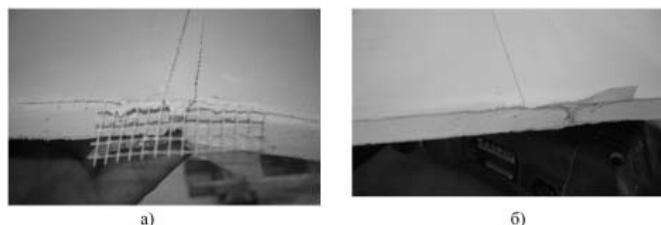
Фото 4. Характер разрушения стыков при армировании сетчатой лентой (а) и бумажной лентой (б)
