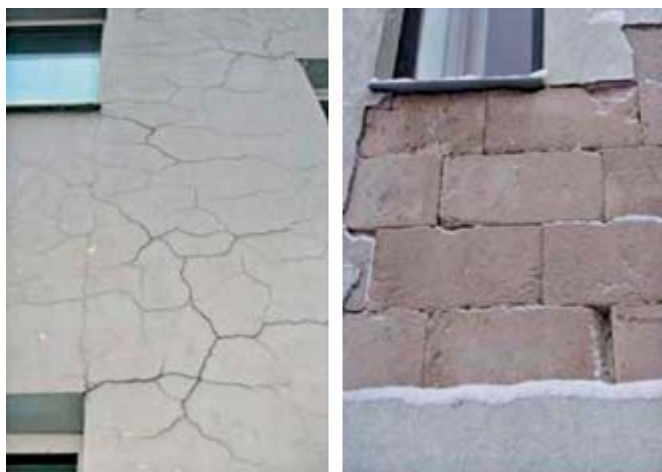
Рис. 12. Разрушение и отслоение штукатурного покрытия от газобетонной кладки [23].
