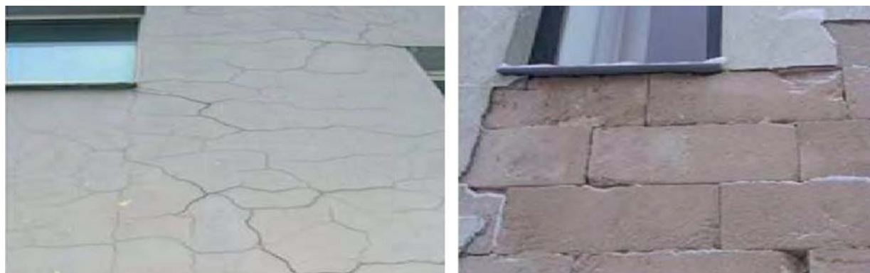
Рис. 9. Разрушение и отслоение штукатурного покрытия от газобетонной кладки
