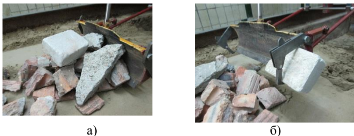
Рис. 6. Модулювання процесу розбирання уламків: а – переміщенням усіх уламків моделлю відвалу бульдозера; б – схопленням окремих уламків захватом
