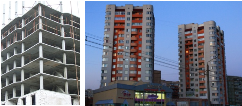
Рисунок 2 – Загальний вигляд житлових 16-ти поверхових будинків у м. Полтаві по вул. Богдана Хмельницького, 21 (зліва) та по вул. Жовтневій, 60-д (справа) у процесі зведення
