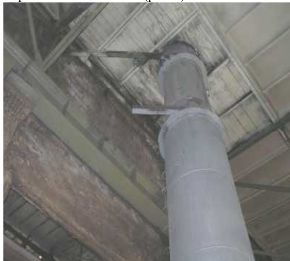
Рис 4. Две распорки на отм. +10.800 (в уровне подкрановой балки) вырезаны /Two struts at elevation +10.800 (In the level of crane beams), cut
