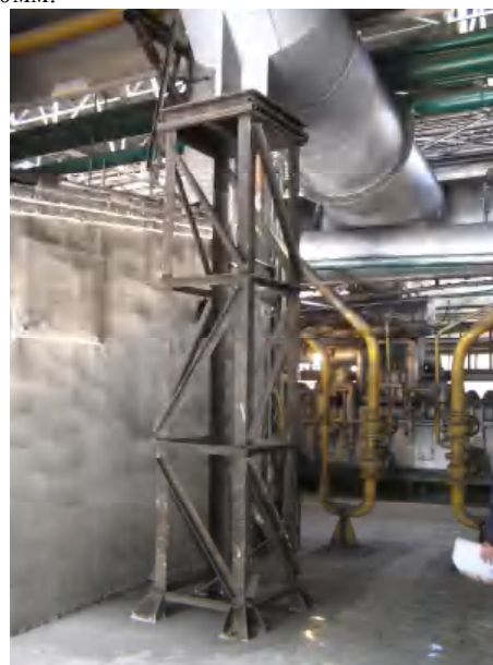
Рис 3. Труба опирается на пространственную металлическую опору/The pipe rests on the metal support spatial
