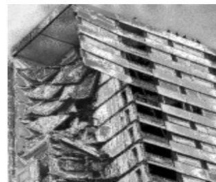
Рис. 1. Пошкодження житлового будинку «Ronan Point». 16 травня 1968р.
