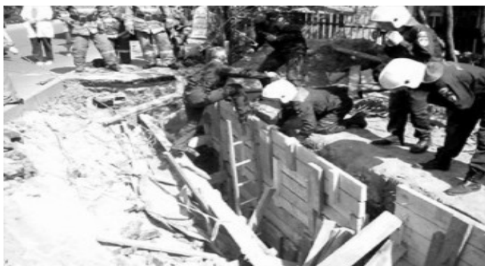
Фото 1. Типичный пример нарушения правил охраны труда при проведении работ по ремонту сетей в стесненных условиях
