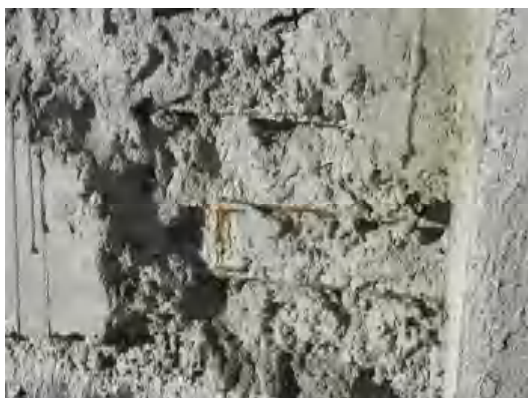
Рис. 4. Дефекты бетонирования каркаса жилого здания
