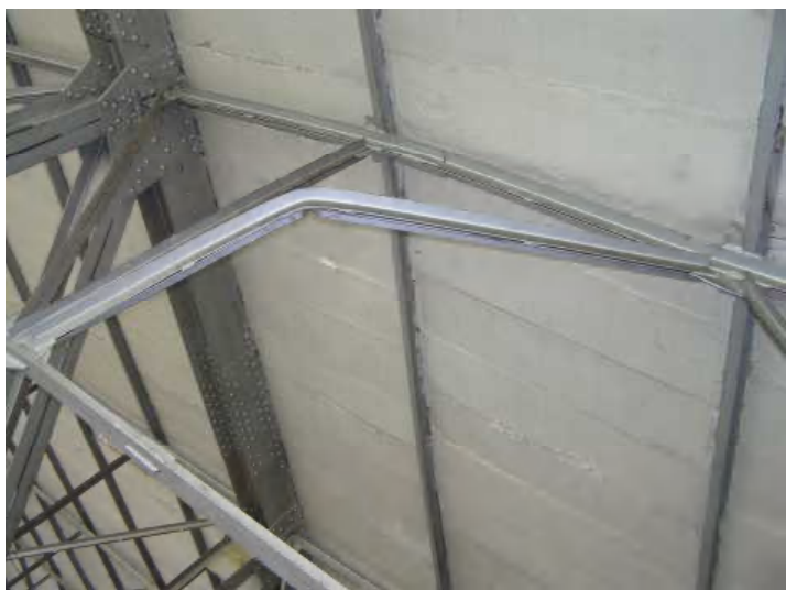
Рис. 2. Общий вид опорного раскоса второстепенной фермы потерявшего устойчивость
